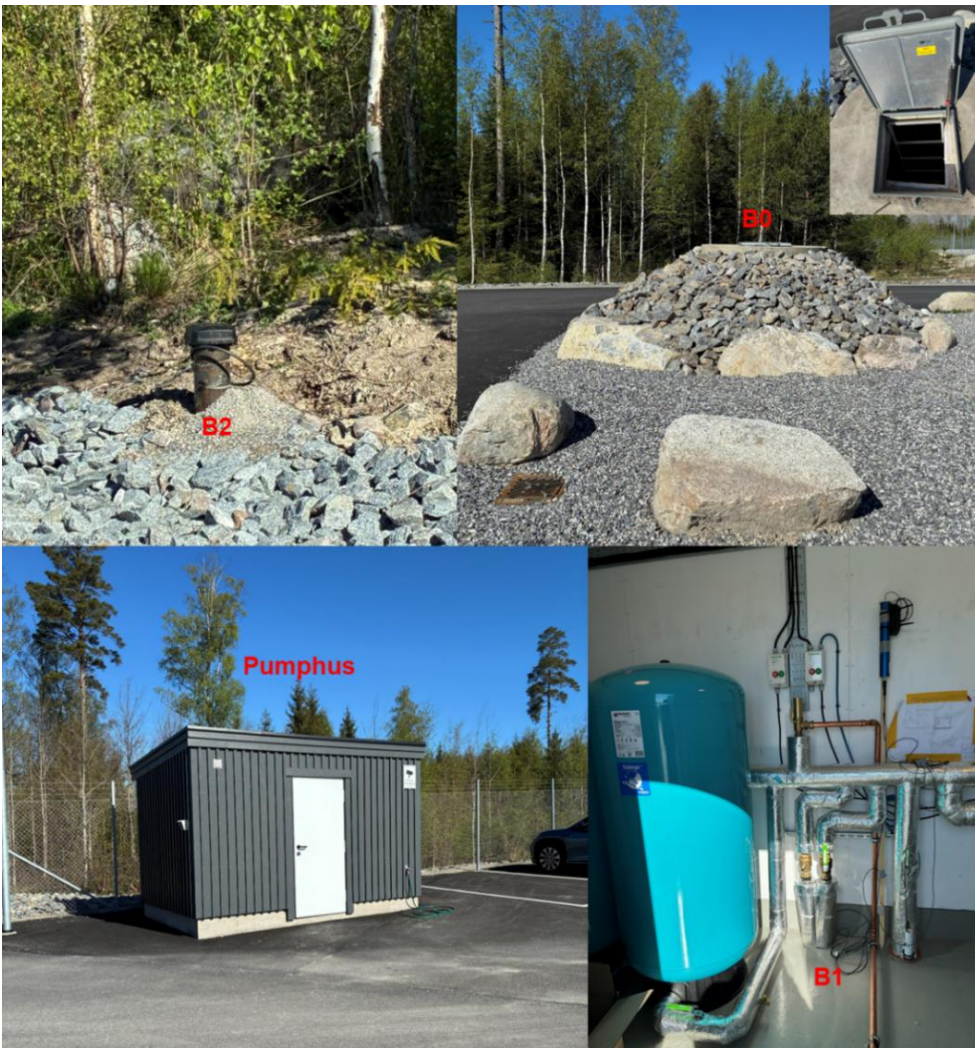
Figur 6-2. De två översta bilderna, samt den nedre högra bilden visar tre av brunnarna. En av brunnarna är placerad direkt under pumphuset som visas på bilden i nedre vänstra hörnet.
